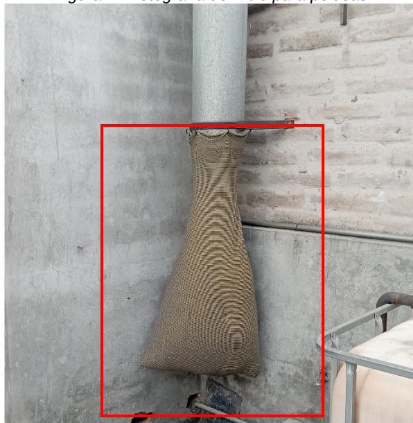
Figura 17 Fotografía del filtro para pelusas
