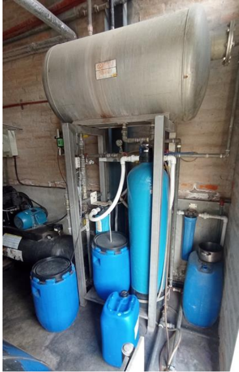
Figura 21 Fotografía del tratamiento para ablandamiento del agua
