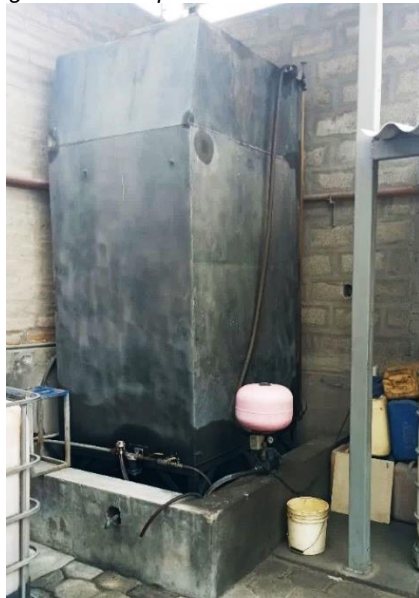
Figura 23 Fotografía del tanque de almacenamiento de combustible
