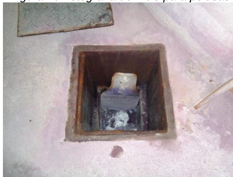
Figura 26 Fotografía del filtro para pelusas
