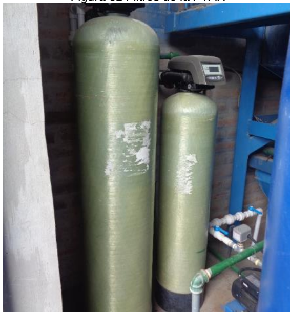
Figura 31 Filtros de la PTAR
