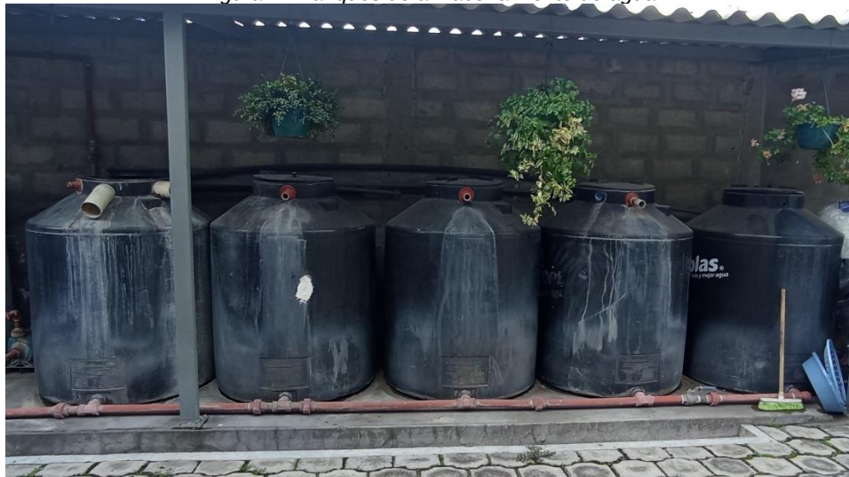
Figura 22 Tanques de almacenamiento de agua
