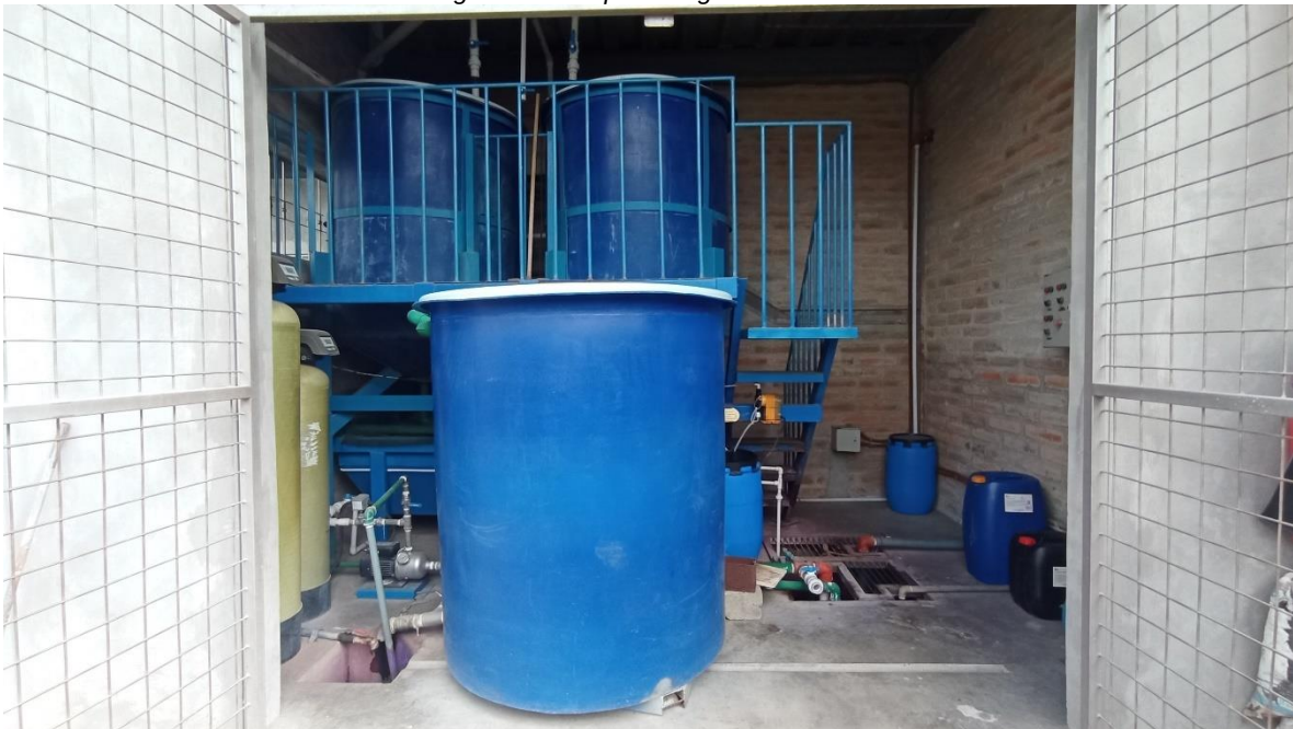
Figura 30 Tanque de agua clarificada
