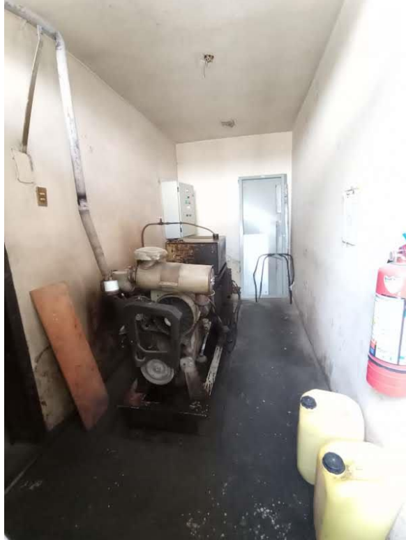
Imagen 16 Generador de energía para emergencia
