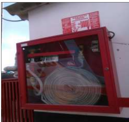
Gabinete contra incendios
