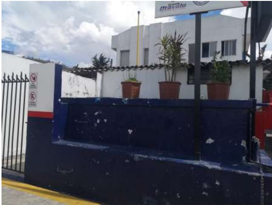
Foto No 21. Cisterna de agua
