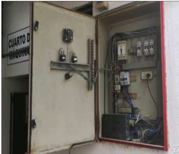
Foto No 11. Tablero de distribución eléctrica.
