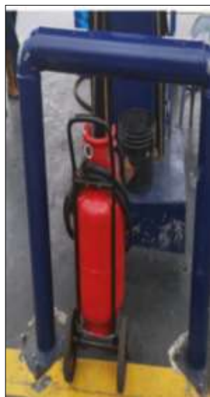
Extintor área de descarga
