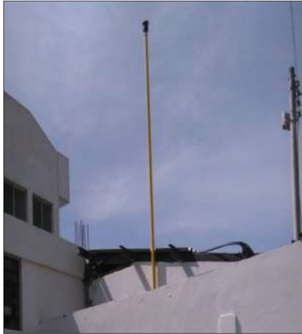
Foto No 28. Tubos de venteo.
