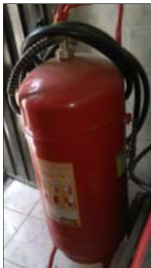
Extintor cuarto de máquinas
